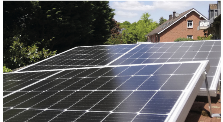
Eine auf einem Dach installierte Mini-Solaranlage. Foto: Stadt Geldern
